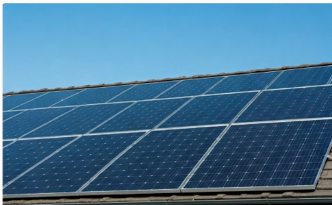
Eguzki-energia fotovoltaikoa Elektrizitate propioa sortzea, sarearekiko mendekotasuna murriztuz.
